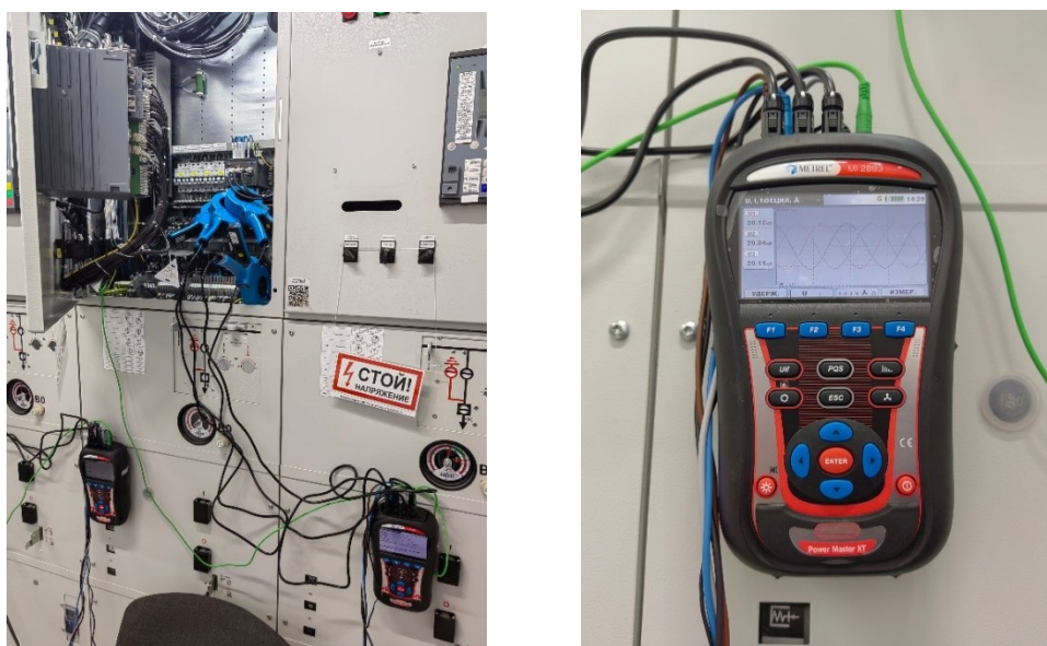
Рис. 2. Регистрация ПКЭ на ПС «Кольская ВЭС» Fig. 2. Power quality indices recording at the Kola Wind Farm substation
