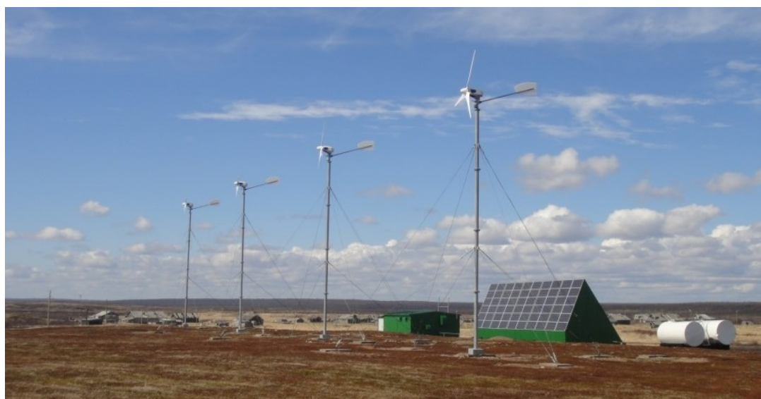
Рис. 22. Гибридная ветродизельносолнечная установка в с. Пялица на южном побережье Кольского полуострова. Введена в эксплуатацию в 2014 г.
